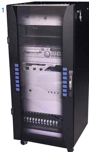
Armoire de commande et de sonorisation (FMU/FMP). Sound and control panel (UMF/PMF).
